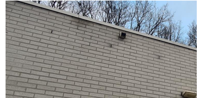
Figuur 5: Open stootvoegen in de zuidgevel van het tankstation
