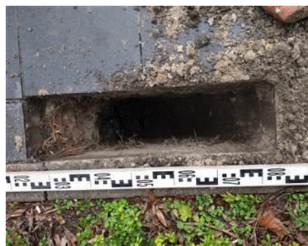
Afbeelding 22: intensieve opnamebeworteling onder de verharding.
