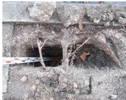
Afbeelding 36: intensief doorwortelde toplaag
