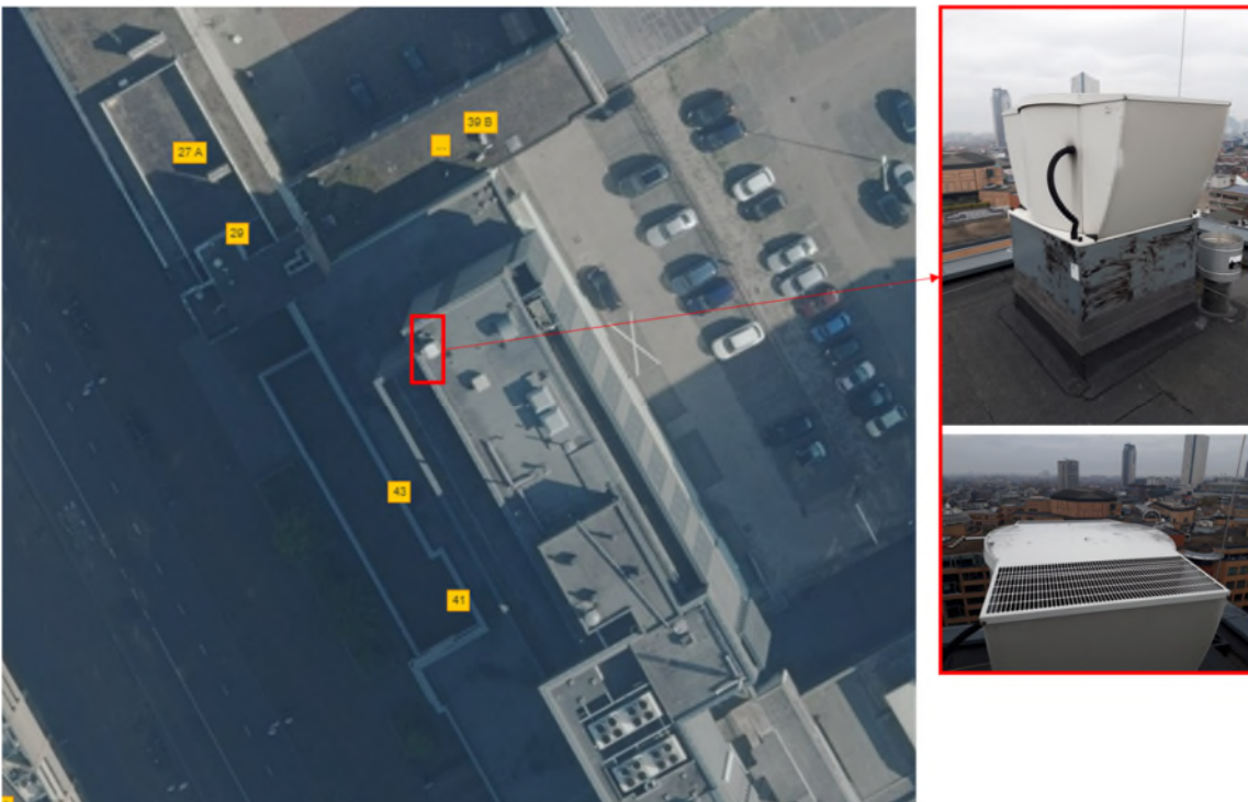
Afbeelding 3: Dakventilator noordzijde Pullman hotel
