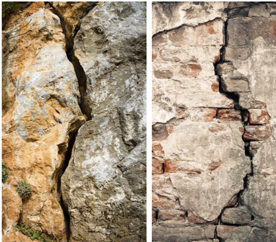
Figuur 2.2. Foto links: natuurlijke verblijfplaats in een rotsspleet. Foto rechts: een beschadiging in een door mensen ontworpen muur. Gebouwen vormen door de natuurlijke voorkeur van vleermuizen een optimale verblijfplaats.
