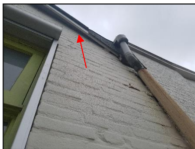
Figuur 10. Spleten tussen muur en daklijst
