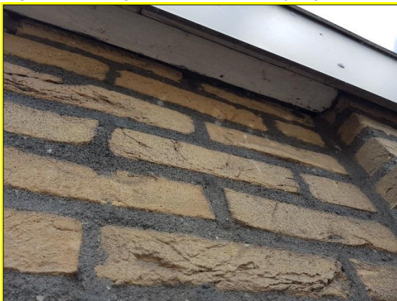
Figuur 9. Kierende dakrand westelijk gebouw
