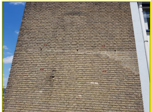
Figuur 10. Open stootvoegen in noordelijk gebouw
