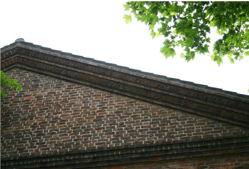
Figuur 4.2.2. De gevelpannen liggen alle in cement.
