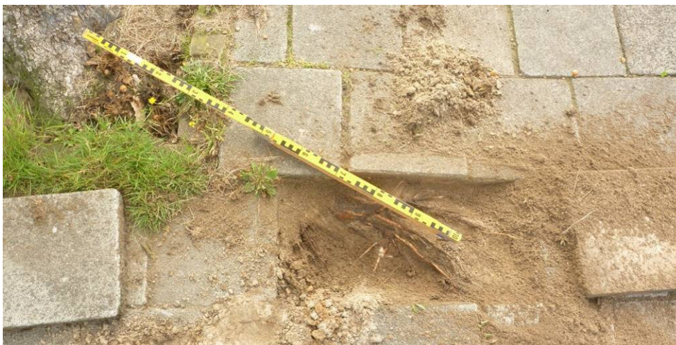
Foto 7. Wortel direct onder bestrating die opdruk veroorzaakt
