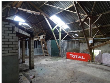
Foto 62: Schuur 2: interieur hoge stal (asbestdak met gaten en openingen).
