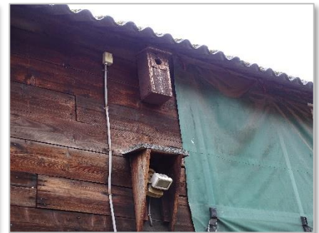
Foto 42: Schuur 1: wegens instortingsgevaar + asbest reeds gesloopt – zie Bijlage 2.
