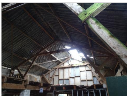
Foto 68: Schuur 2: interieur hoge stal (asbestdak met gaten en openingen).
