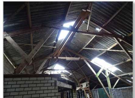
Foto 63: Schuur 2: interieur hoge stal (asbestdak met gaten en openingen).
