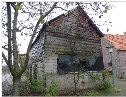
Foto 41: Schuur 1: wegens instortingsgevaar + asbest reeds gesloopt – zie Bijlage 2.
