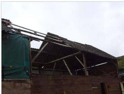
Foto 43: Schuur 1: wegens instortingsgevaar + asbest reeds gesloopt – zie Bijlage 2.
