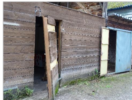
Foto 44: Schuur 1: wegens instortingsgevaar + asbest reeds gesloopt – zie Bijlage 2.
