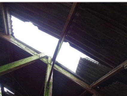
Foto 67: Schuur 2: interieur hoge stal (asbestdak met gaten en openingen).
