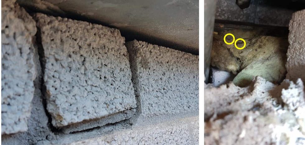
Foto 4. Opening naar spouwmuur (foto links) en vleermuiskeutels (binnen gele cirkels)
