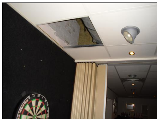
Foto 10 afdichting boven vouwwand en binnenmuur sporthal
