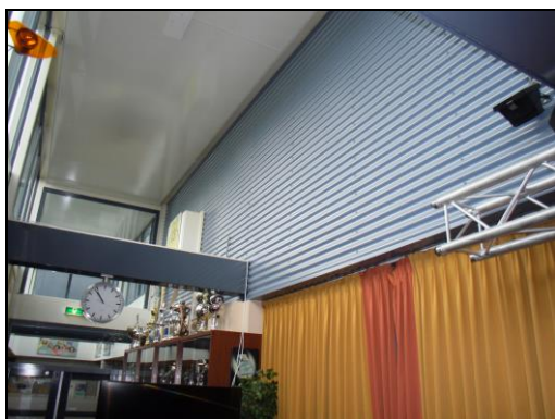
Foto 19 stalen binnenplaat boven kozijnen met sporthal
