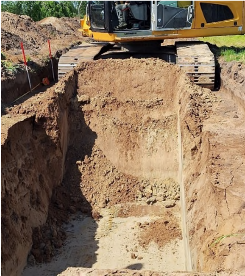
Afbeelding 175. Foto van de uitgraving direct na de laatste haal bij de beek. De wanden waren voor een groot deel al ingestort, de breder wordende scheuren geven weer dat dit proces vervolgde.
