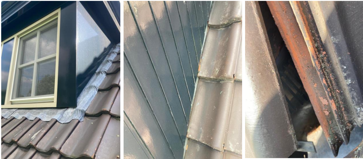
Zicht op een dakkapel, afgekitte spleten tussen dakkapel dak en vogelschroot onder pannen.
