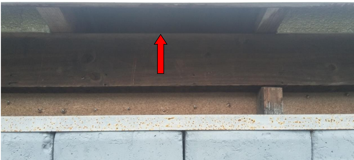
Figuur 13. Grote opening in garagebox. Op een enkele plek ontbreekt een blok isolatieschuim (rode pijl).
