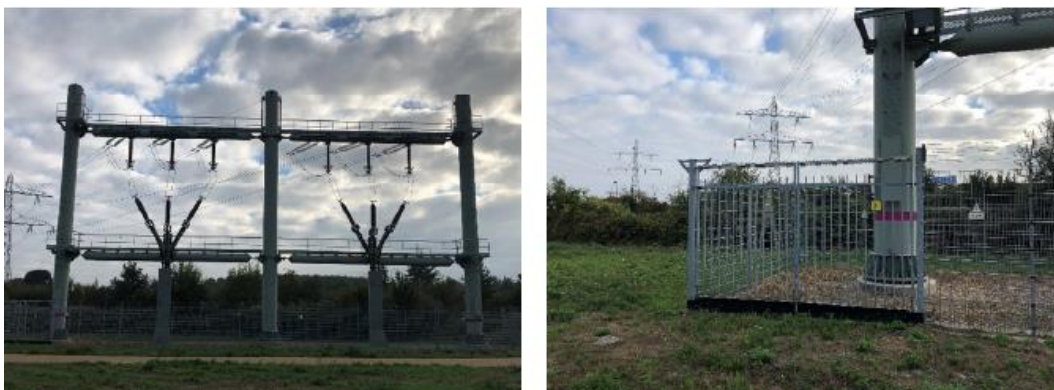
Figuur 2-3: Voorbeeld van een portaal, met overgang van kabel (ondergronds) naar lijn (bovengronds) (bron: TenneT).
