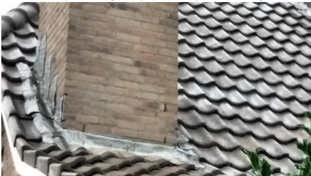
Schoorsteen met open stootvoegen en openstaande dakpannen van woning:
