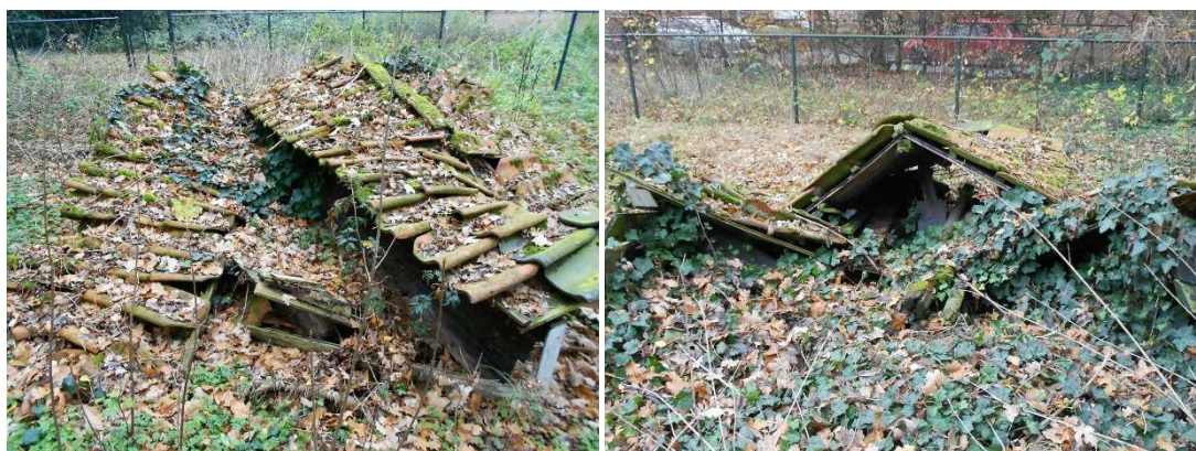
Figuur 7. Het ingestorte schuurtje is niet geschikt als verblijfplaats voor gebouwbewonende vleermuizen.
