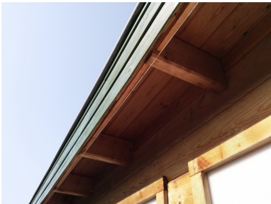
Opstal 3 is volledig dicht, kieren en gaten zijn afwezig. Foto: V. Stuit | Ecoresult B.V.
