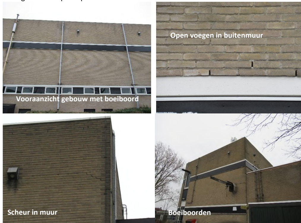
Figuur 4.3. Afbeelding te slopen gebouw met spleten die vleermuizen toegang bieden tot de spouwmuur.
