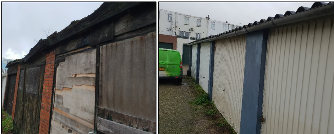
Figuur 3: Garageboxen van deel B waarvan de westelijke rij op veel locaties brandschade bevat.
