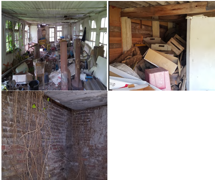
Figuur 4.3. Leegstaande of vervallen panden in het plangebied.
