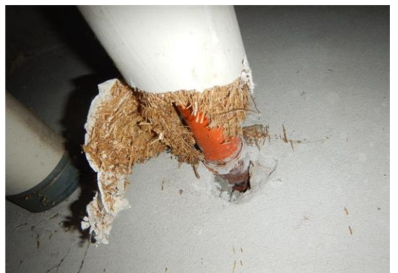
Moderne leidingisolatie en geen koord bij doorvoeren
