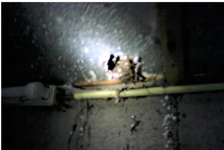
Figuur 8. Door een gat in de plafondplaat puilt nestmateriaal van de huismus uit.
