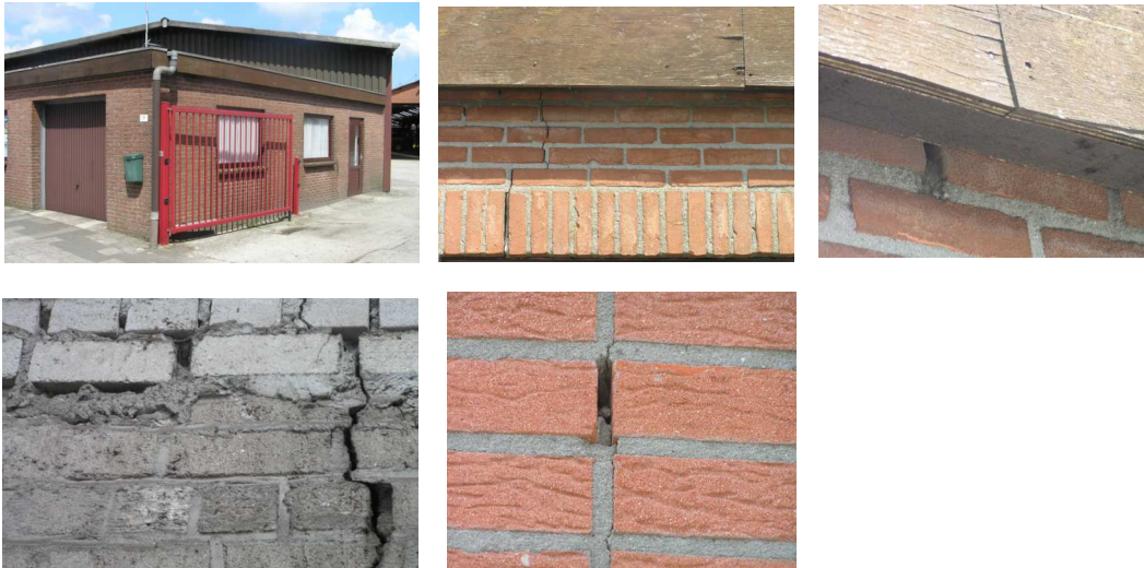
Figuur 7: daklijst van het bijgebouwtje en een van de aangetroffen open voegen in de spouwmuren van het bijgebouwtje en de loodsen (Croonen Adviseurs, 2009).
