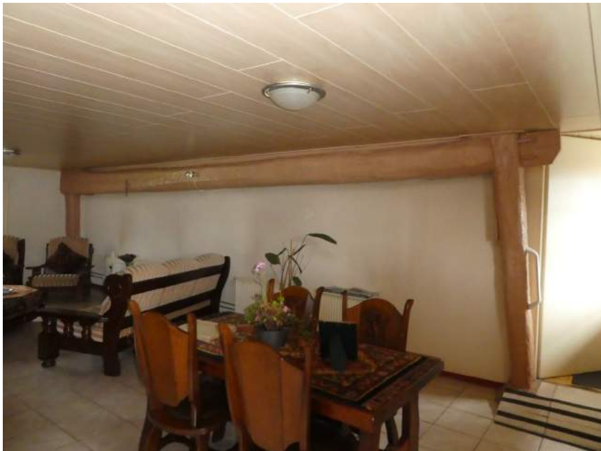
Nabij een nieuwe scheidingsmuur in de voormalige stal is een langere ankerbalk in de enige in-situ overgebleven oude gebintstijl bevestigd.
