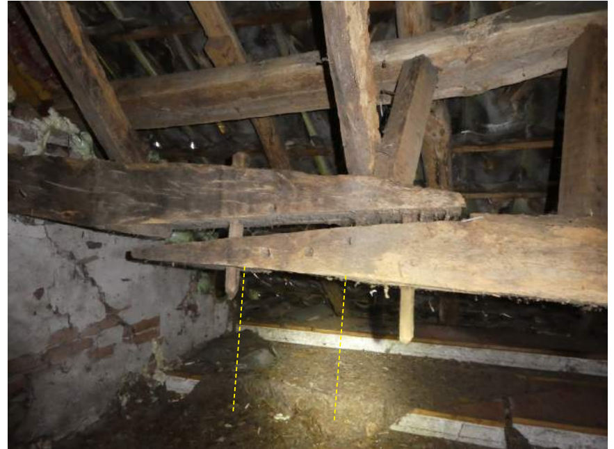
De verbinding of 'las' van de gebintplaat is met twee pennen verankerd. De plaats van de gebintstijl was constructief gezien niet logisch.
