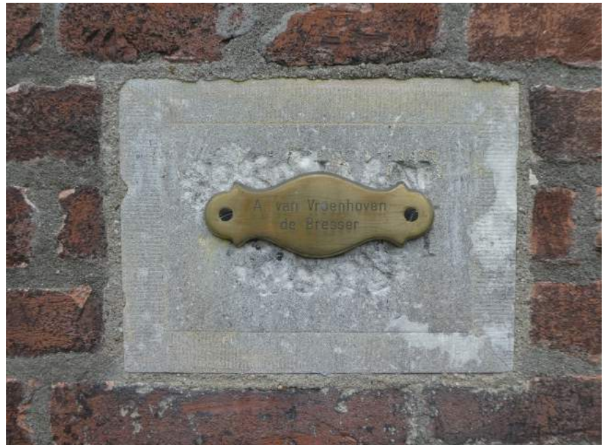
Gewelsteen met weggehakte tekst, latere opschildering en daar overheen naamplaatje. Naast de steen zijn initialen in bakstenen ingekrast. MVV duidt mogelijk op de naam van een familielid van Fam. Van Vroenhoven.
