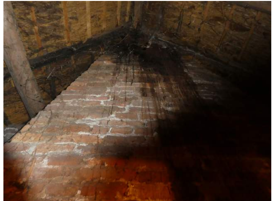
Detail van rookkanaal in inbouwkast.
