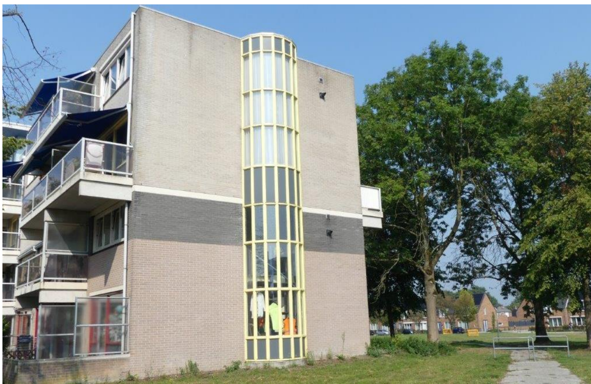
Foto 1 Het gebouw heeft een blinde muur met open stootvoegen. Vleermuizen kunnen hier hun verblijfplaats in de spouw hebben. In de bomen direct naast het gebouw kunnen vogels broeden.
