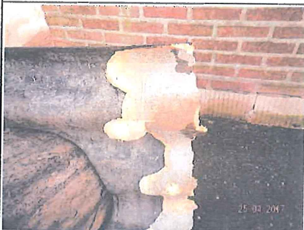
Foto 21. Ventilatie kap met pur en restanten golfplaat.
