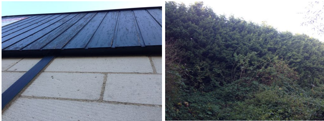
Figuur 3 Alle gevels zijn nauwkeurig geïnspecteerd op het de aanwezigheid van potentiële invliegopeningen (afbeelding links). De luwte van gebouwen en opgaande groenstroken bieden goede omstandigheden voor vleermuizen met betrekking tot vliegen en foerageroutes (afbeelding rechts).
