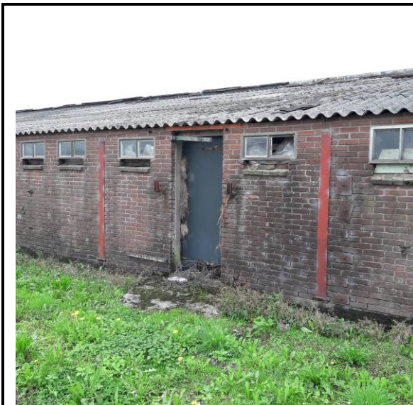
Foto 9: buitenzijde stal, asbestverdachte dakbedekking
