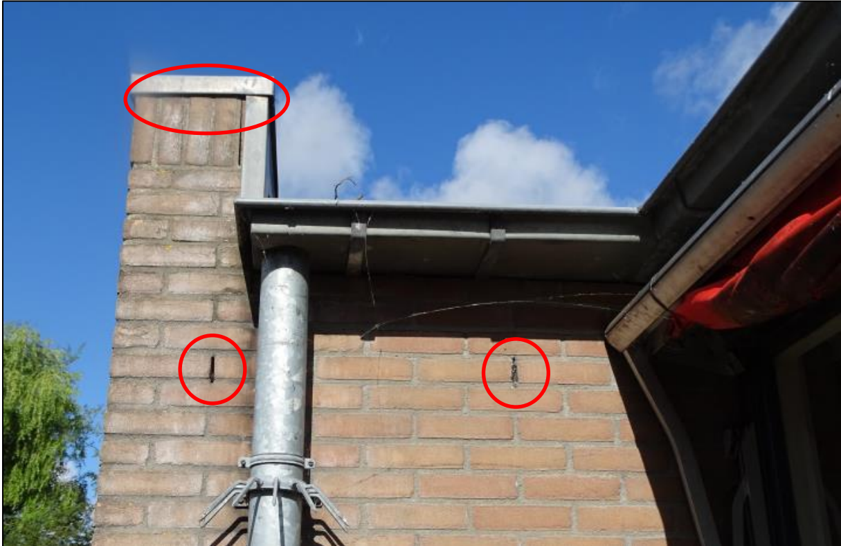
Figuur 5.6. Openstootvoegen en ruimte onder de daktrim aan de zijkant van de bebouwing.
