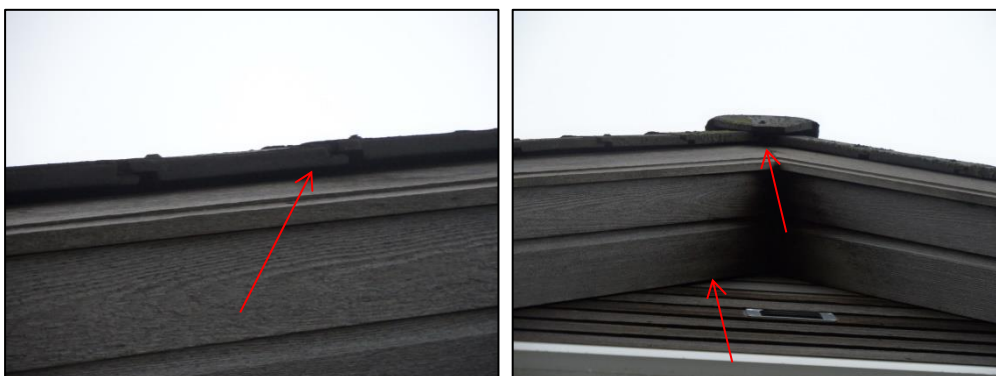
Detailfoto's van de woning op het Achterbos 32 R-1. Onder de nok van het dak, tussen de houten muur en het dakbeschot en onder de dakpannen zijn kieren zichtbaar. Een verblijfplaats van vleermuizen is hier niet op voorhand uit te sluiten.
