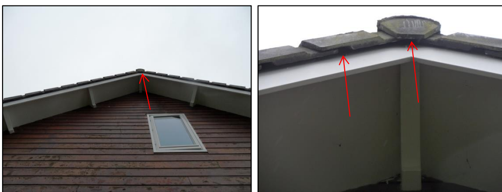
Detailfoto's van de woning op het Achterbos 36 R-20. Onder de nok van het dak en onder de dakpannen zijn kieren zichtbaar. Een verblijfplaats van vleermuizen is hier niet op voorhand uit te sluiten.
