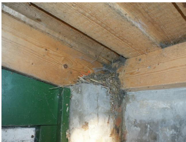
Dakconstructie binnenkant met oud vogelnest
