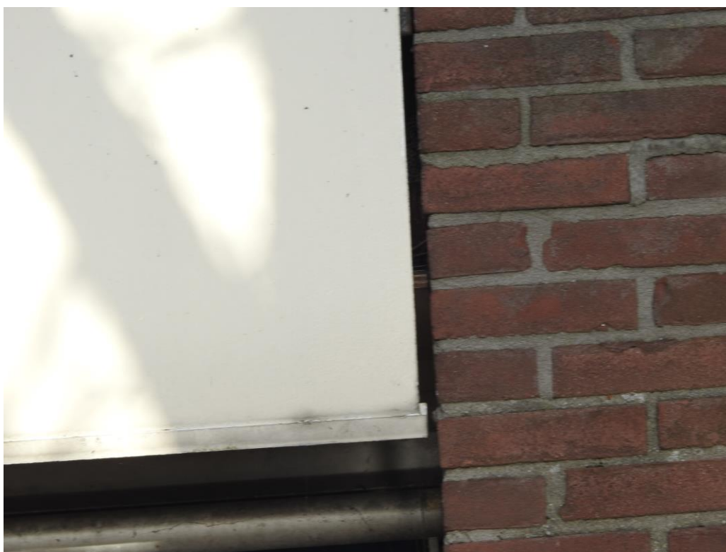
Foto 3. Kieren achter gevelbeplating.
