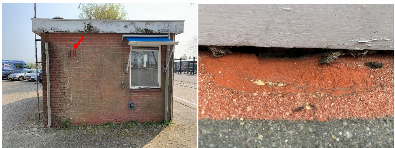
Figuur 4.4.3. Het kantoorgebouwtje bij de weegbrug (links) bevat ventilatiesleuven die toegang geven tot de spouw (aangeduid met rode pijl) en een met de gevel kierende betimmering (foto rechts).
