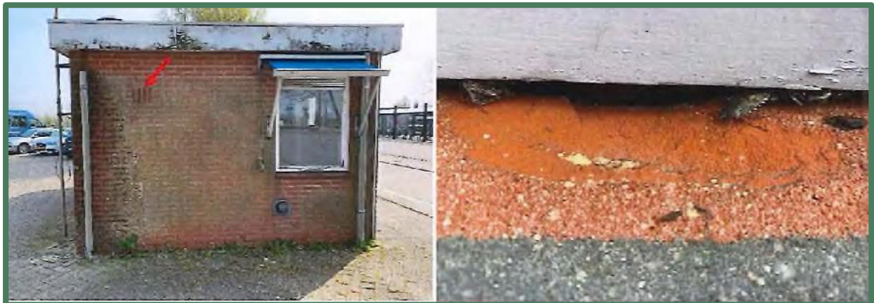
Het kantoorgebouwtje bij de weegbrug (links) bevat ventilatiesleuven die toegang geven tot de spouw (aangeduid met rode pijl) en een met de gevel kierende betimmering (foto rechts). Bron: Aeres Milieu BV
