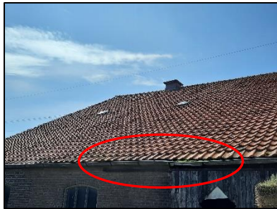
Figuur 15. Potentiele huismusbroedlocaties tussen de dakpannen en dakgoot met rode cirkels gemarkeerd (opstal 2).
