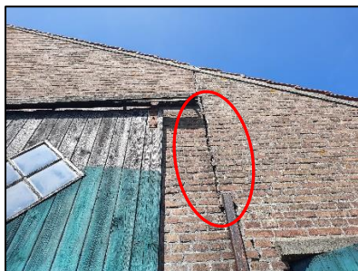
Figuur 24. Scheur aanwezig in de oostelijke buitenzijde van de schuur met een rode cirkel gemarkeerd (opstal 2).
