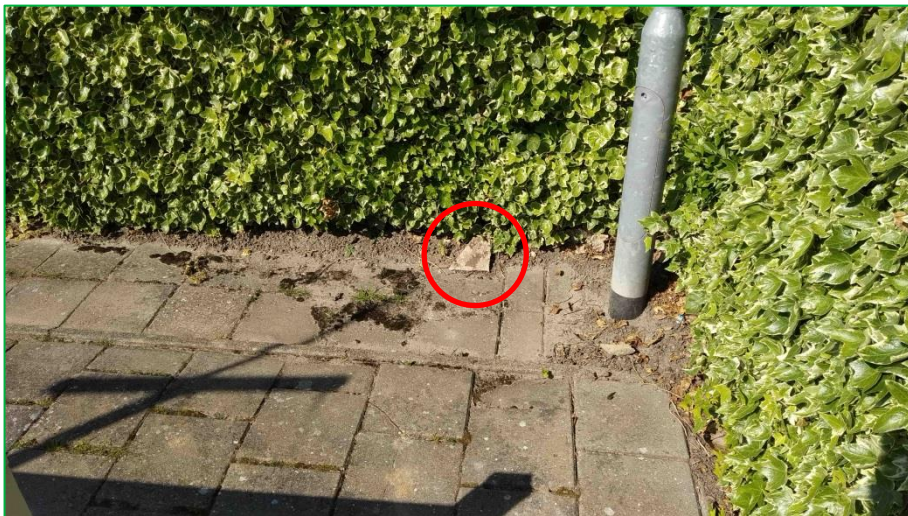
Foto 4. Asbestverdachte plaat rood omcirkeld.
