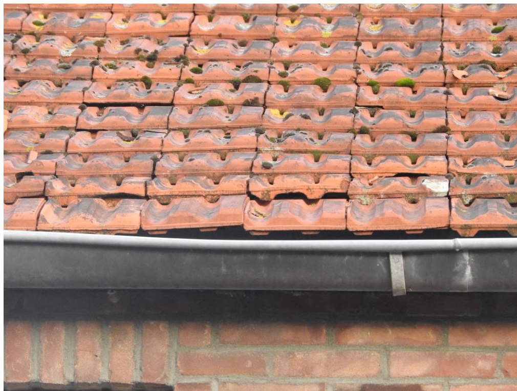
Foto 1. Openingen tussen dakpannen en dakgoot.
