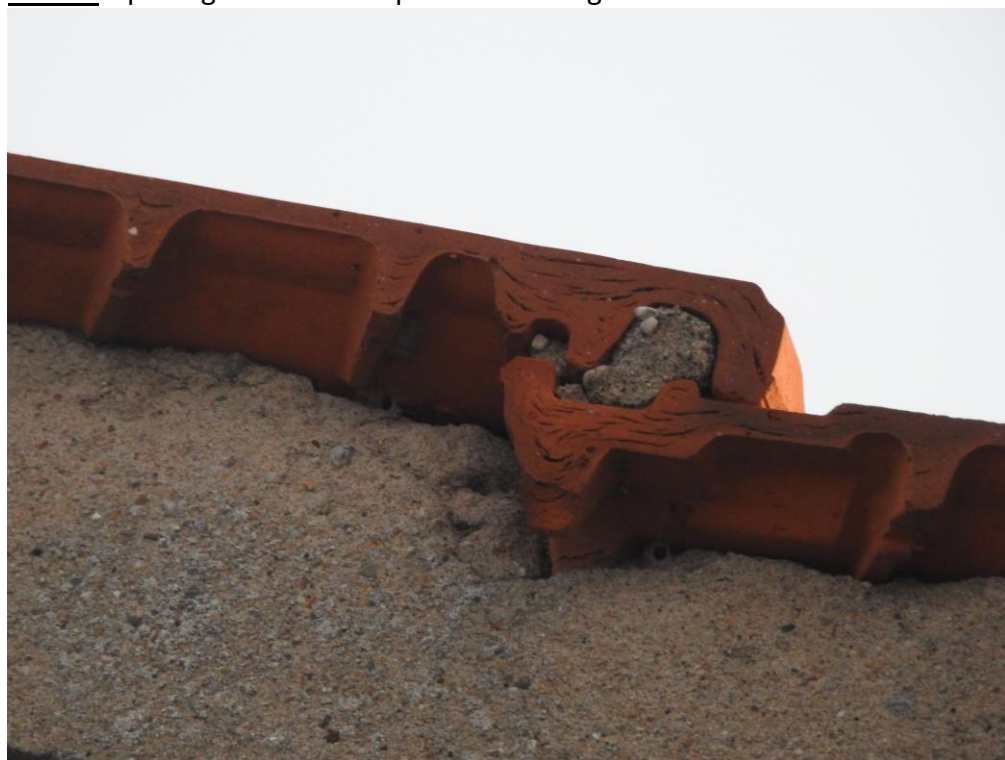
Foto 2. Loszittende dakpannen op kopgevels.
