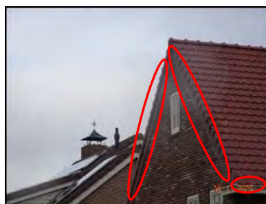
Figuur 13. Woning, met ruimte onder dakrand kantpannen en dakgoot (aangegeven met rode cirkels), direct ten noordwesten van de onderzoekslocatie.
