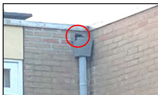
Afbeelding 5: Opening in gevel bij hemelwaterafvoer
