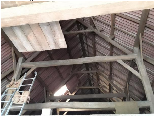
Schuur 2: geen dakisolatie
