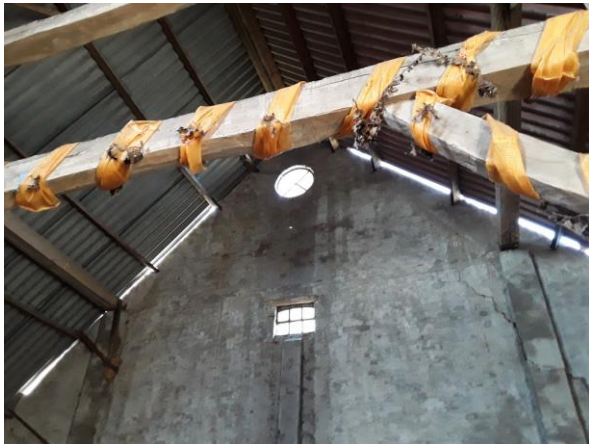
Schuur 1: geen dakisolatie
