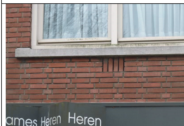
Fig. 5. Er zijn aan de voorkant meerdere open ventilatie- en open stootvoegen in het gebouw van de kapsalon.
