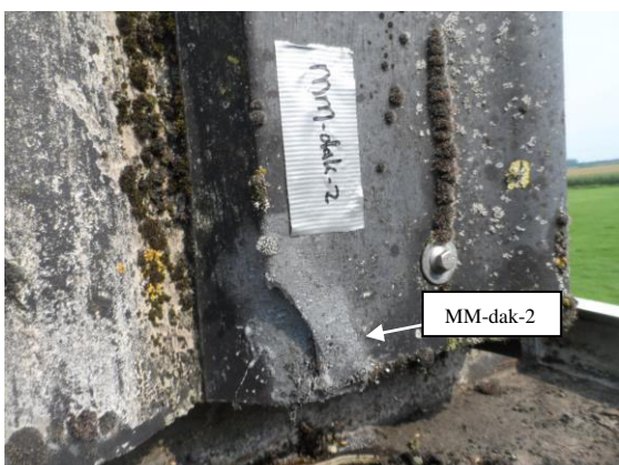
Foto 5: Asbesthoudende windveren als afwerking van van de gevels t.p.v. de dakbedekking. (zie ook foto 3)
