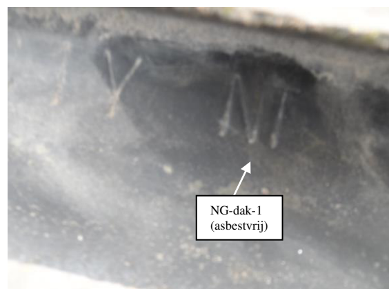
Foto 6: Asbestvrije golfplaat als gedeeltelijke van de schuur. (NT-code waargenomen)
