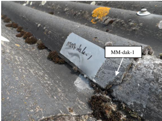
Foto 1: Asbesthoudende golfplaat als gedeeltelijke dakbedekking van de schuur.
