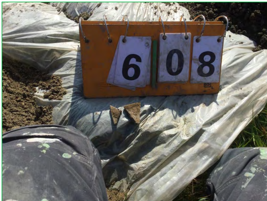
Foto 9. Asbesthoudend materiaal proefgat 608
