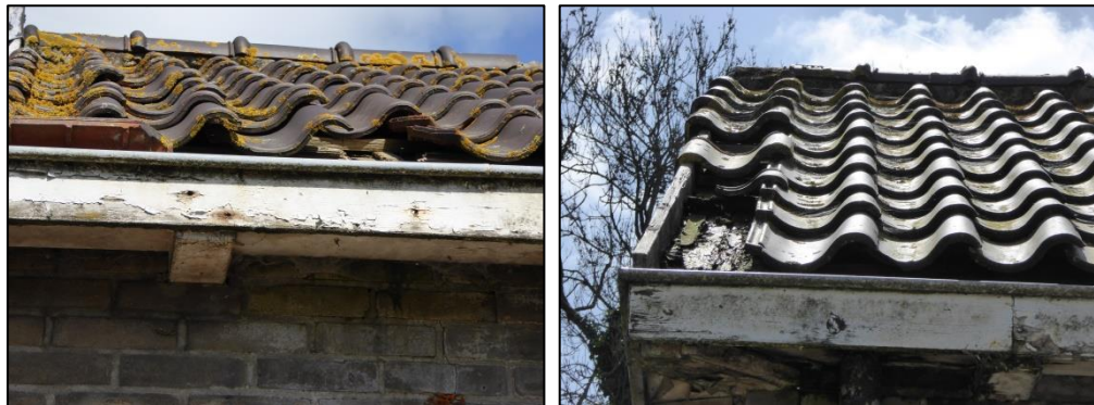
Missende dakpannen en ruimte onder dakpannen in het plangebied.
