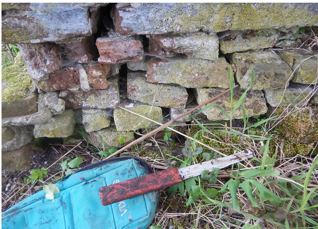
Figuur 5: Foto van de onderzijde van de bouwmuur aan de voorzijde van de boerderij.
