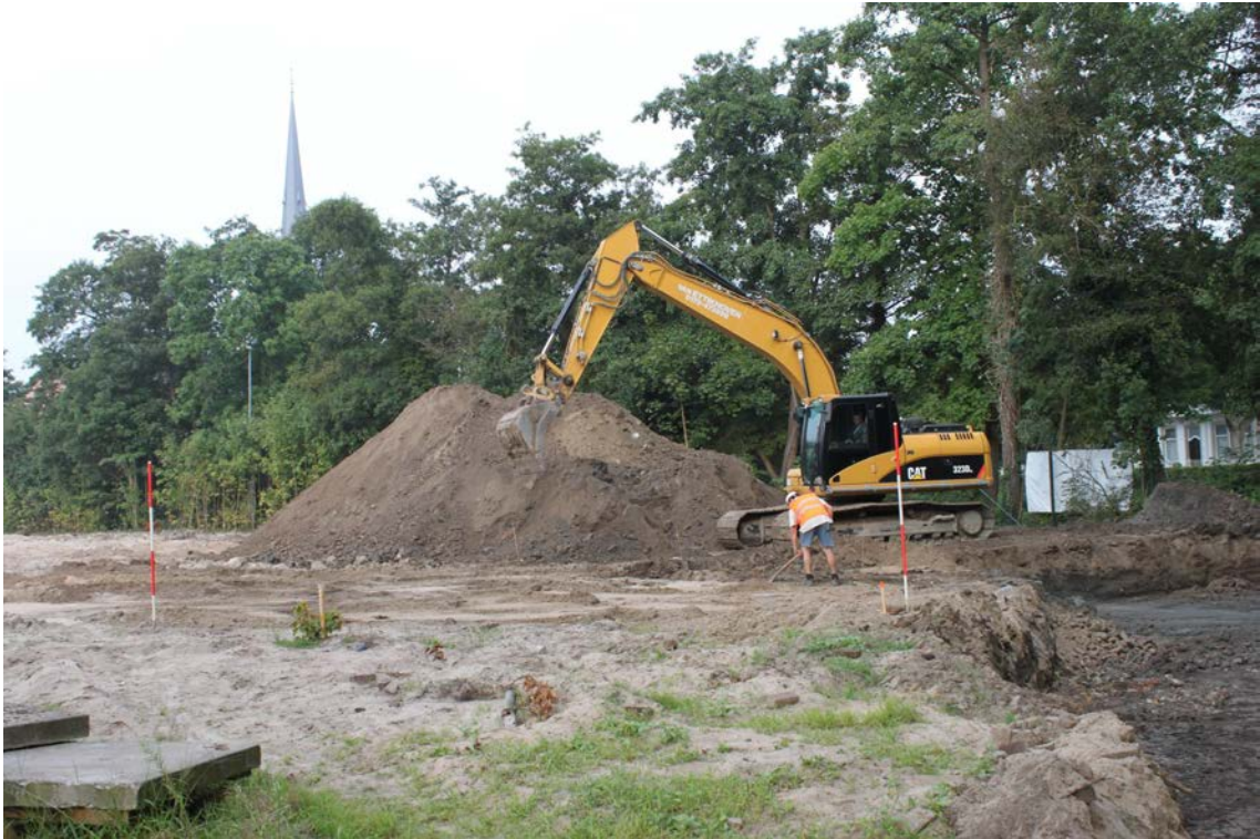
Figuur 11: Woerden, Defensie-eiland. Foto van werkzaamheden tijdens het aanleggen van vlak 1 in werkput 1 in het noorden van het plangebied.
