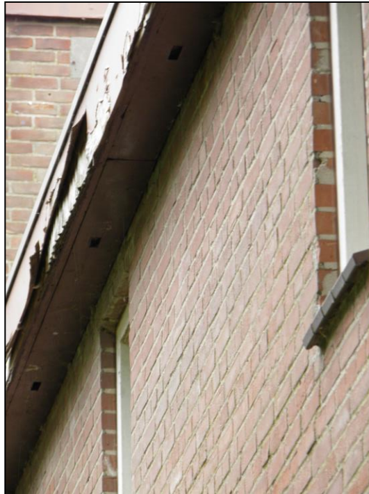
Figuur 4. Gaten in de houten overstek bieden mogelijk toegang tot open ruimte. Hiermee kunnen ze geschikt zijn voor een vleermuisverblijfplaats.
