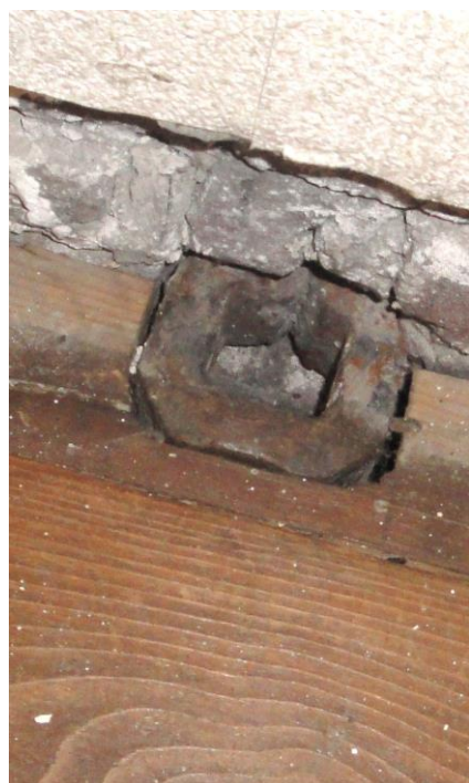
Afb. 42: restant staartanker 1834 in de vloer van de tweede verdieping
