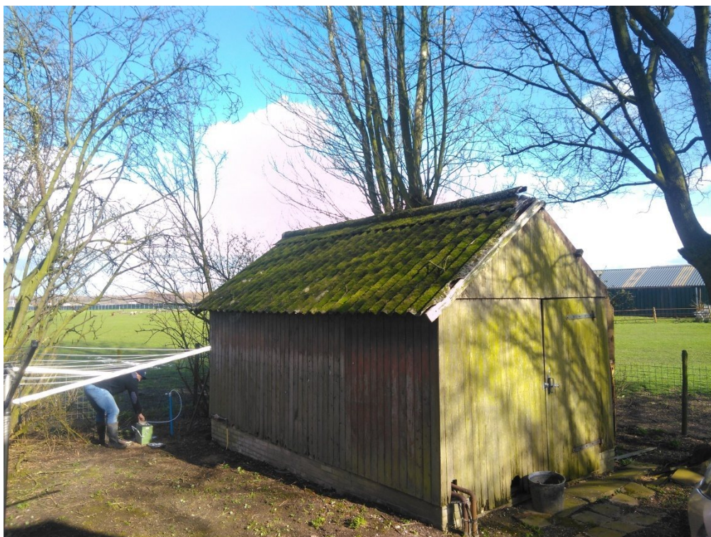
Foto 2: Zuidbuurt 75B, schuurtje zonder dakgoot met daarachter bovengrondse HBO-tank
