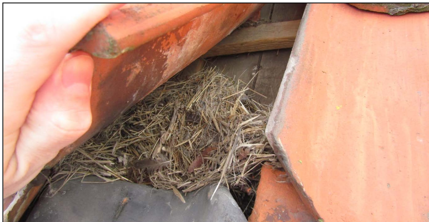
Figuur: onder de dakpannen van de woning op het oostelijke perceel zijn (oude) huismusnesten aanwezig.
